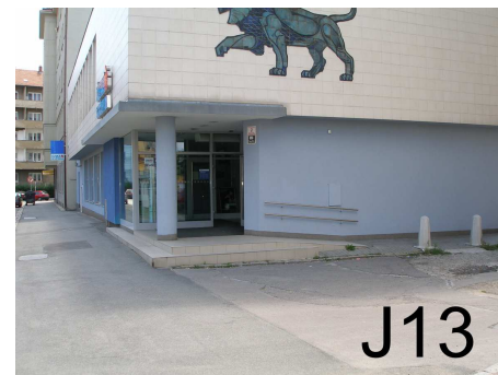
-částečně bezbariérový vstup do objektu ozn. 100-chybí zábradlí na straně asf.plochy,poškozený povrch asf.plochy, chybí vodící tyč.
