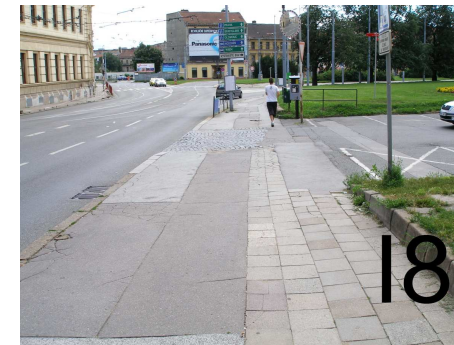
-bezbariérová úprava dl.chodníku Mendlovo náměstí -doporučená oprava povrchu.
