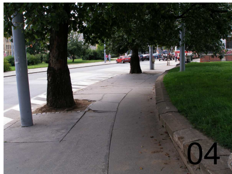
Stáv.asf.chodník s poškozeným povrchem, nutná rekonstrukce. Dl.210 bm-plocha 840 m 2 , Mendlovo náměstí.
