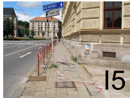
-bezbariérová úprava dl.chodníku Mendlovo náměstí -doporučená oprava povrchu.
