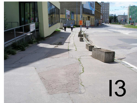
-částečně bezbariérová úprava asf.chodníku Mendlovo náměstí -doporučená oprava povrchu.
