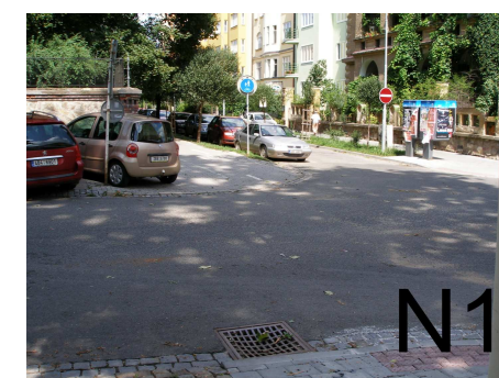
-stávající místo na přecházení,bariérové pro osoby slabozraké,varovný pás v kontrastním provedení pouze na jedné straně,na straně druhé schází. Doporučená stavební úprava umístěním var.pásu v kontr.barvě i na druhou stranu přechodu.
