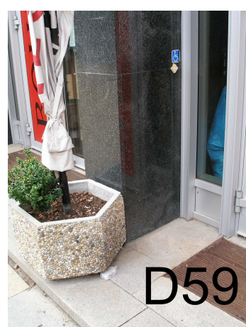
-bariérový vstup do obj.ozn.068 pro osoby se ZP -zvonek není v dosahu z vozíku+ schodek
