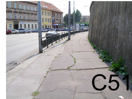
-bezbar.úprava chodníku ulice Koliště-druhá strana-část s poškozeným povrchem nutná oprava
